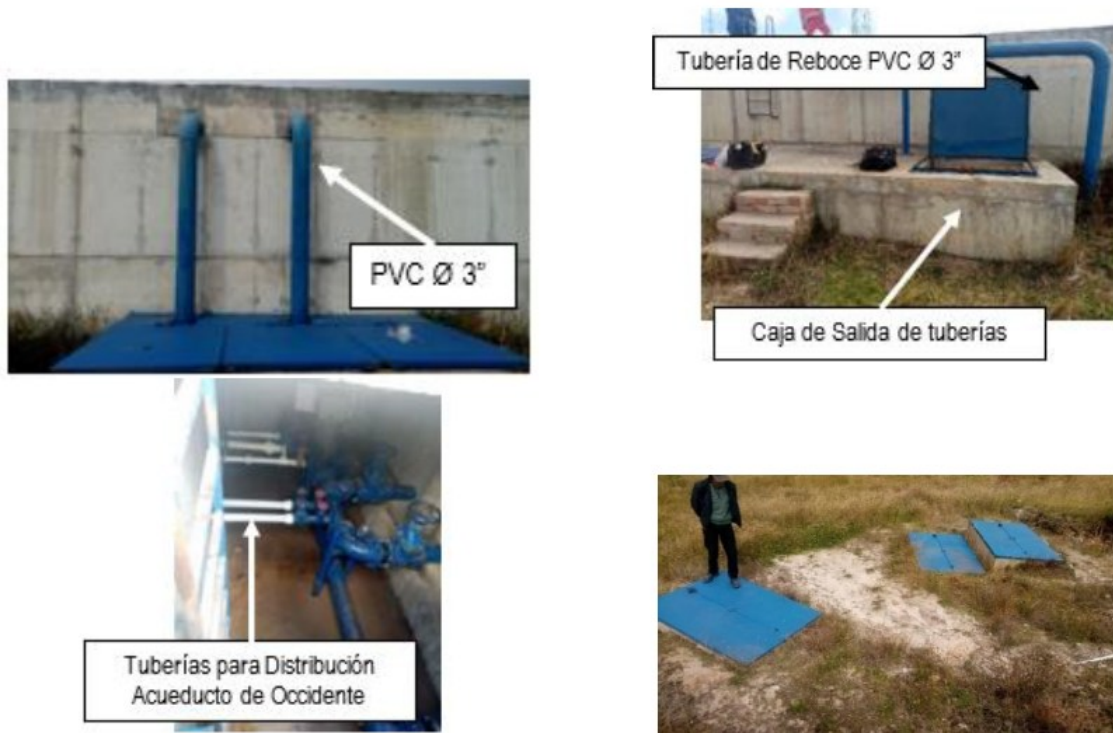
Figura 43. Tanque de transferencia
